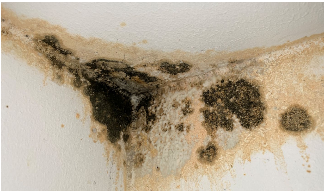
Omfattende fugtskade og skimmelsvampevækst
