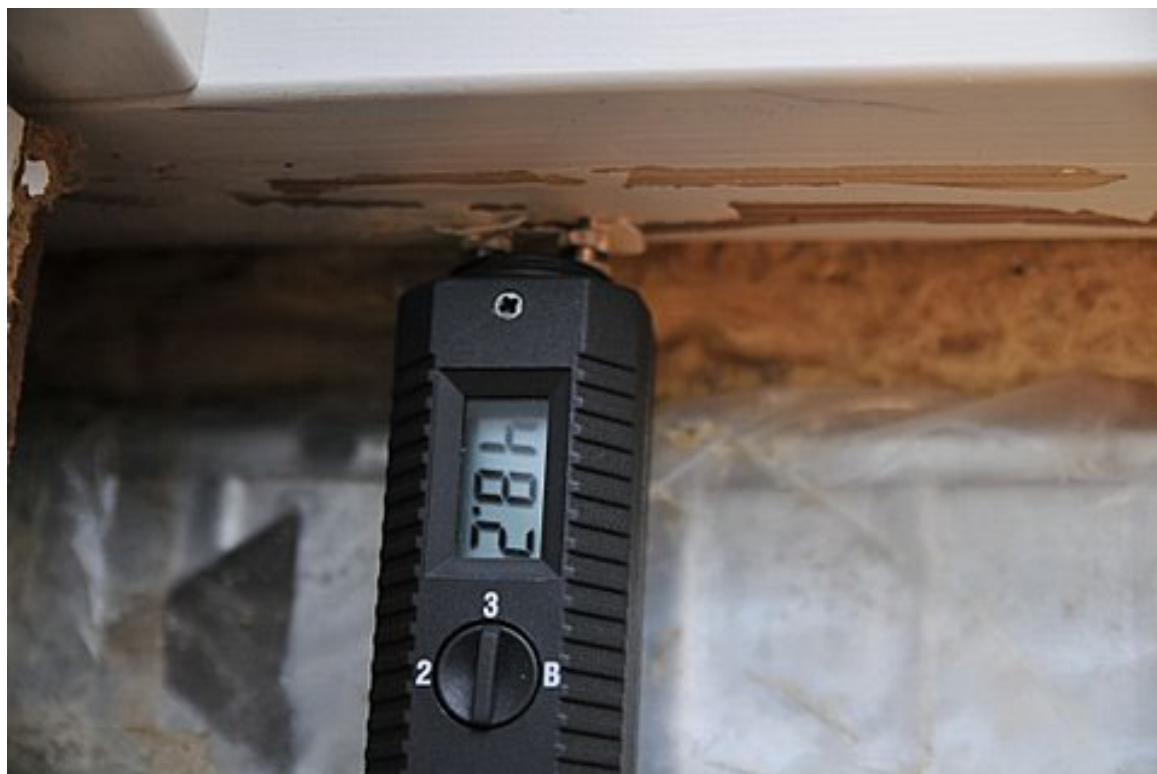
Fugtmåling i vindueskarm af træ.
