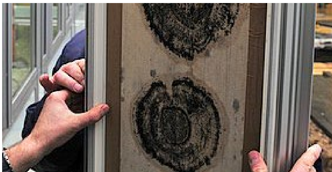
Fund af skimmelsvamp ved undersøgelse af bygning.
