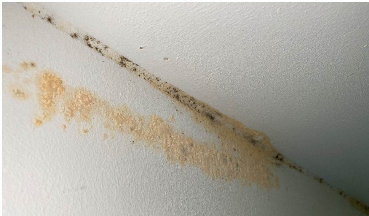
Kuldebro med fugt og skimmelsvamp
